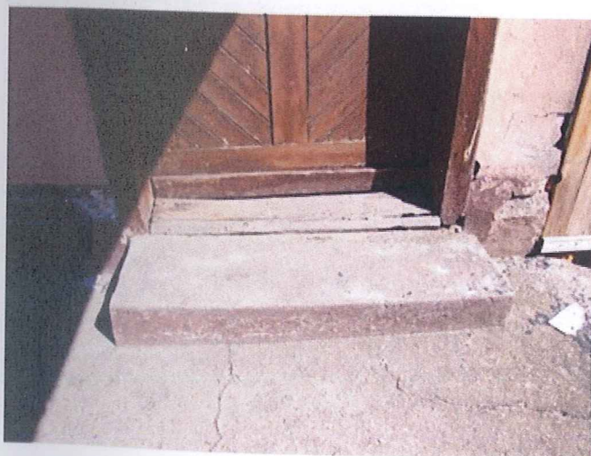
Zniszczony próg głównych drzwi wejściowych do domu podcieniowego
